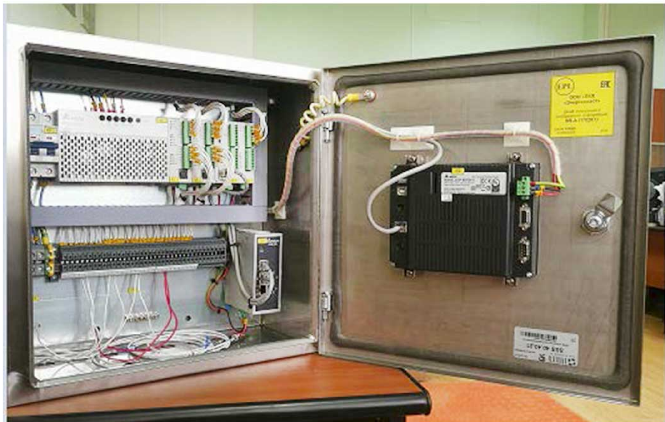
Фотография внутреннего устройства шкафа
