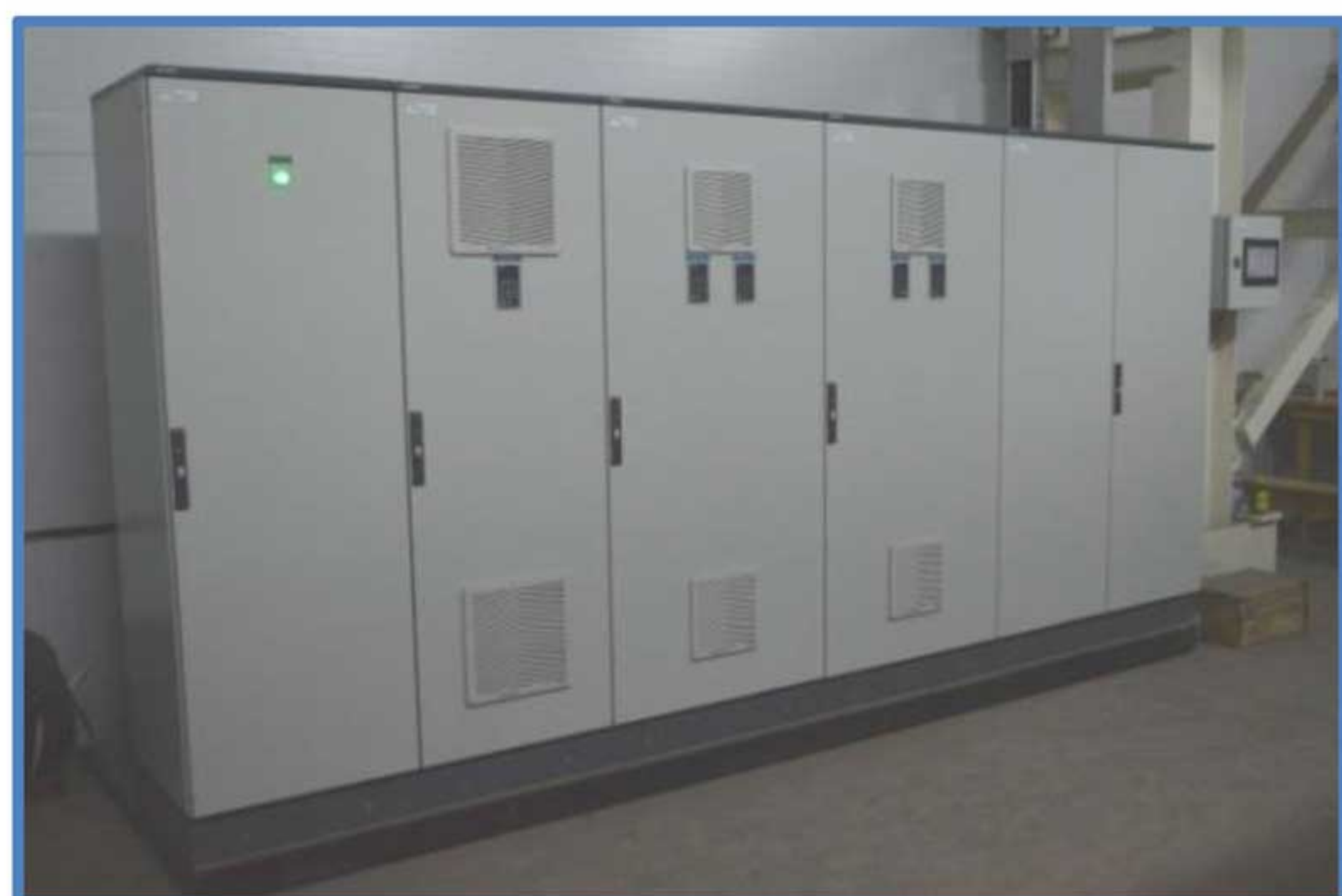
Общий вид силовых шкафов и шкафов управления и автоматики
