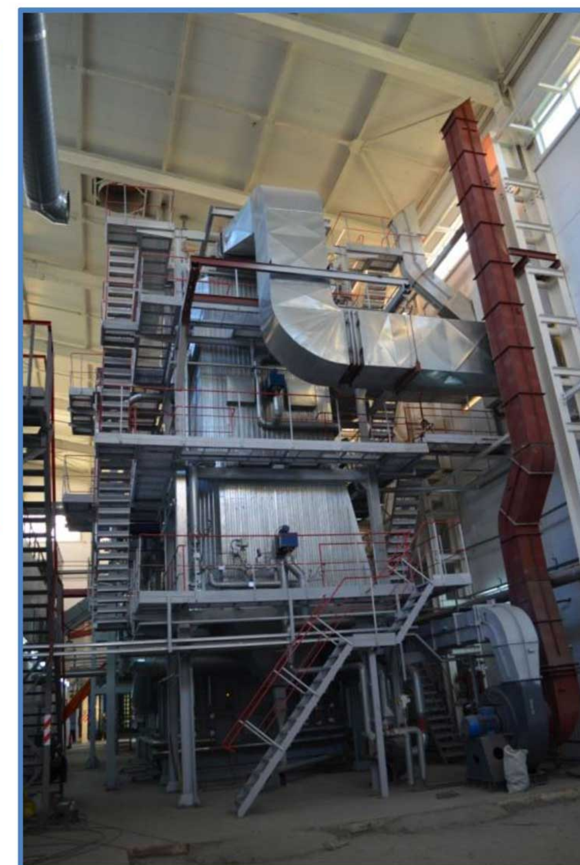
Паровой котел Е-12-1,4Р
