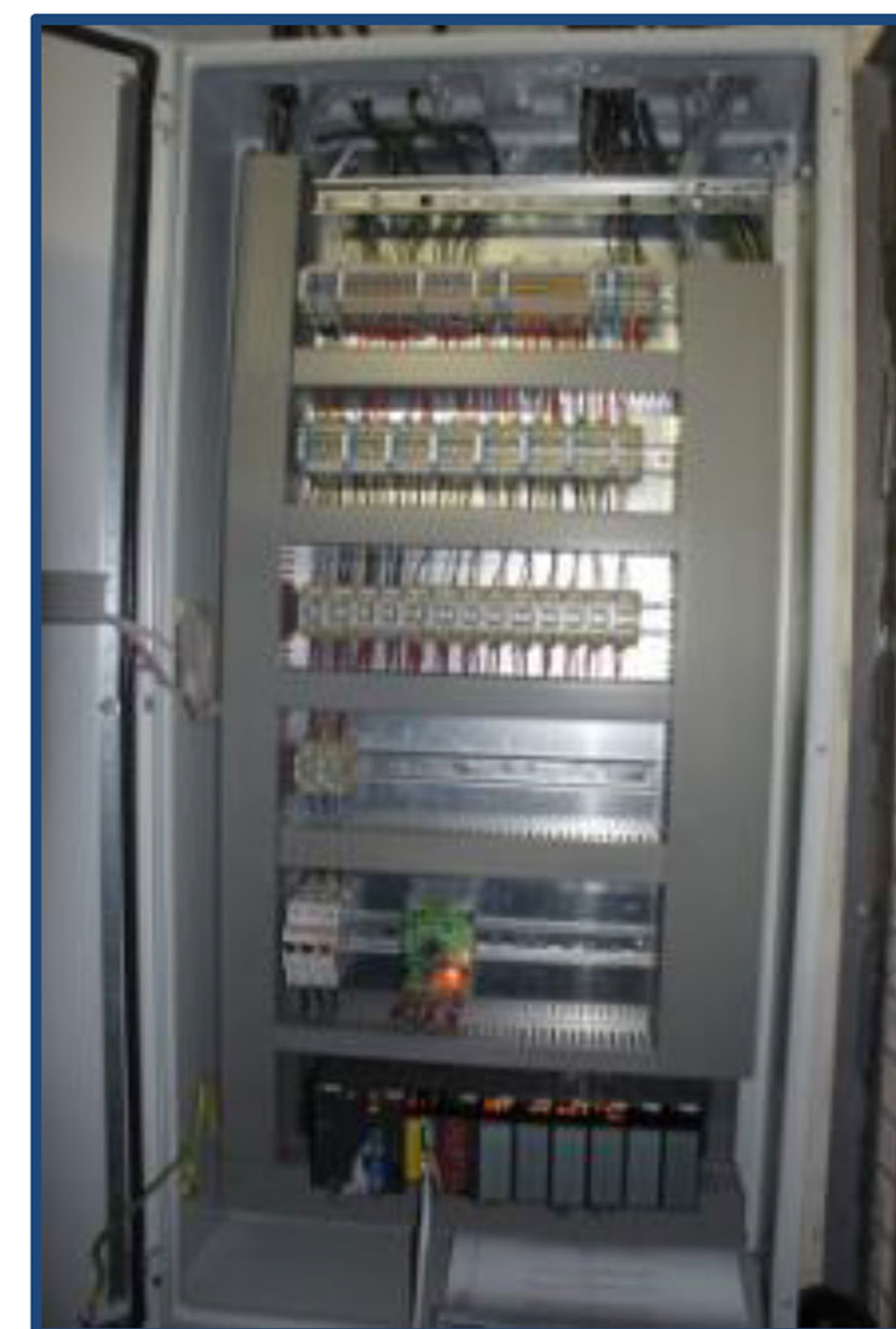
ПЛК DELTA AH500 с модулями расширения в шкафу управления
