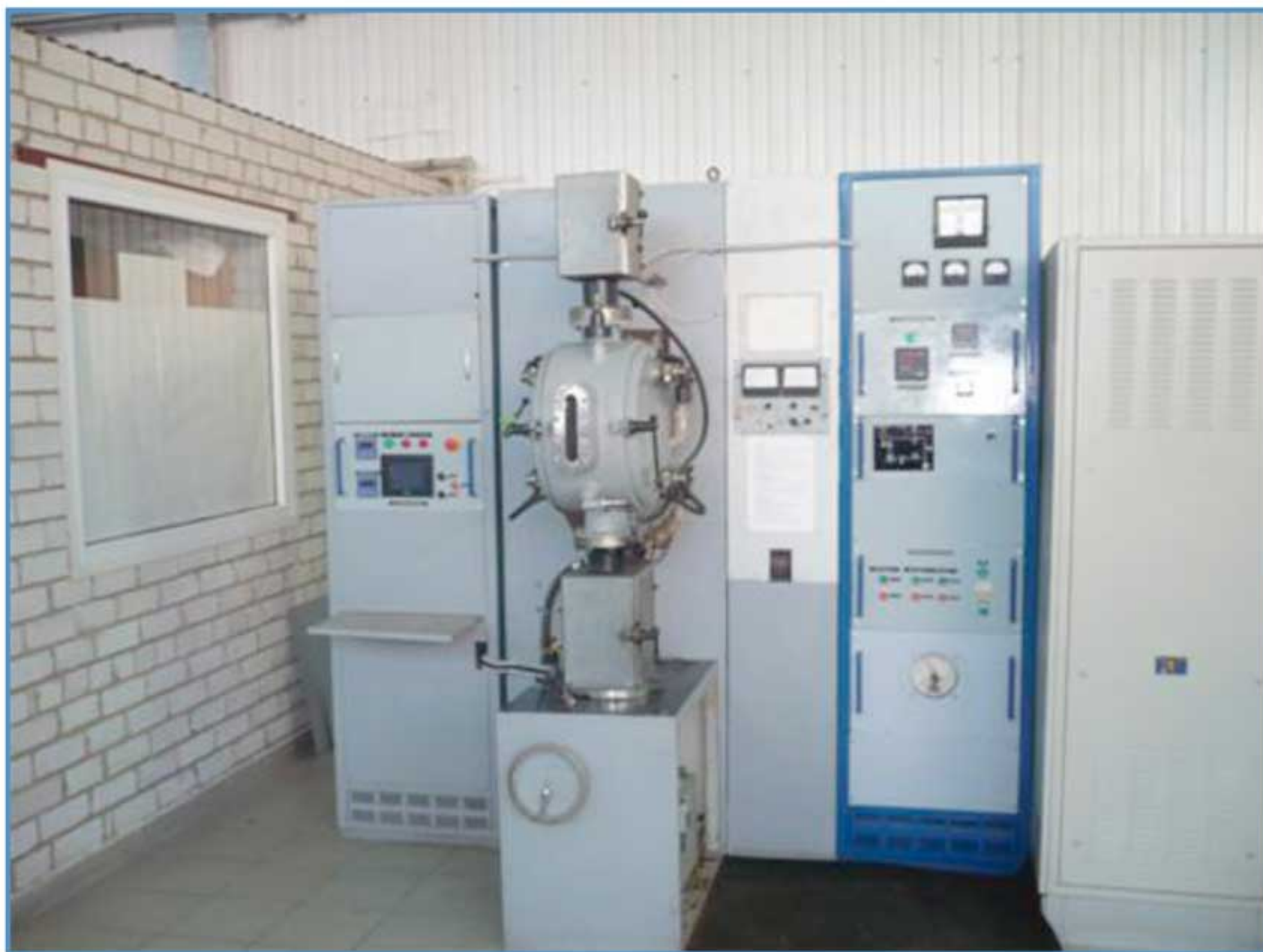
Лицевая панель шкафа управления (блок управления с панелью оператора Delta DOP-B)
