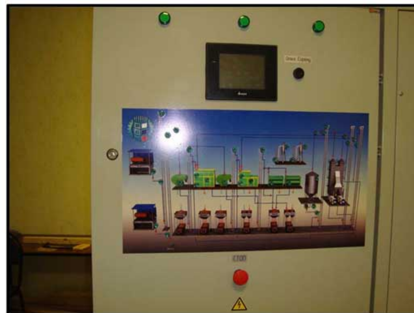
Лицевые панели шкафов, Мнемосхемы, панель оператора DOP-B
